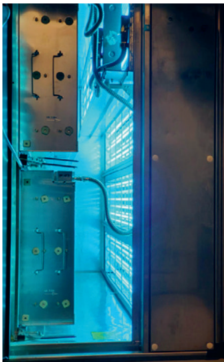
Bild: UV-C-Bestrahlungswand in einer RLT-Anlage
